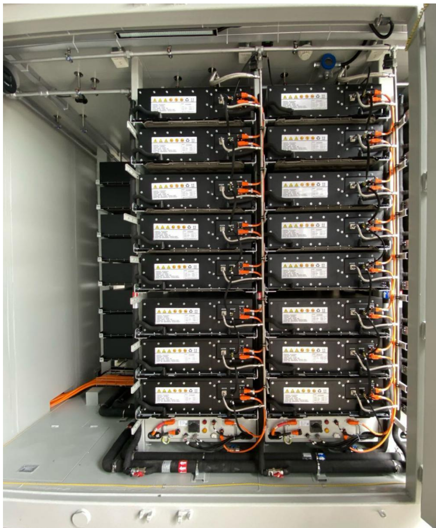
储能舱储能消防管路实物展示图
