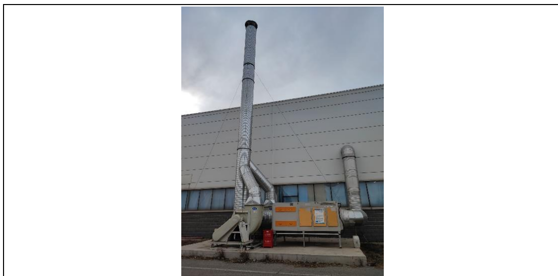
天津基地采用光氧活性炭一体机收集处理车间废气
