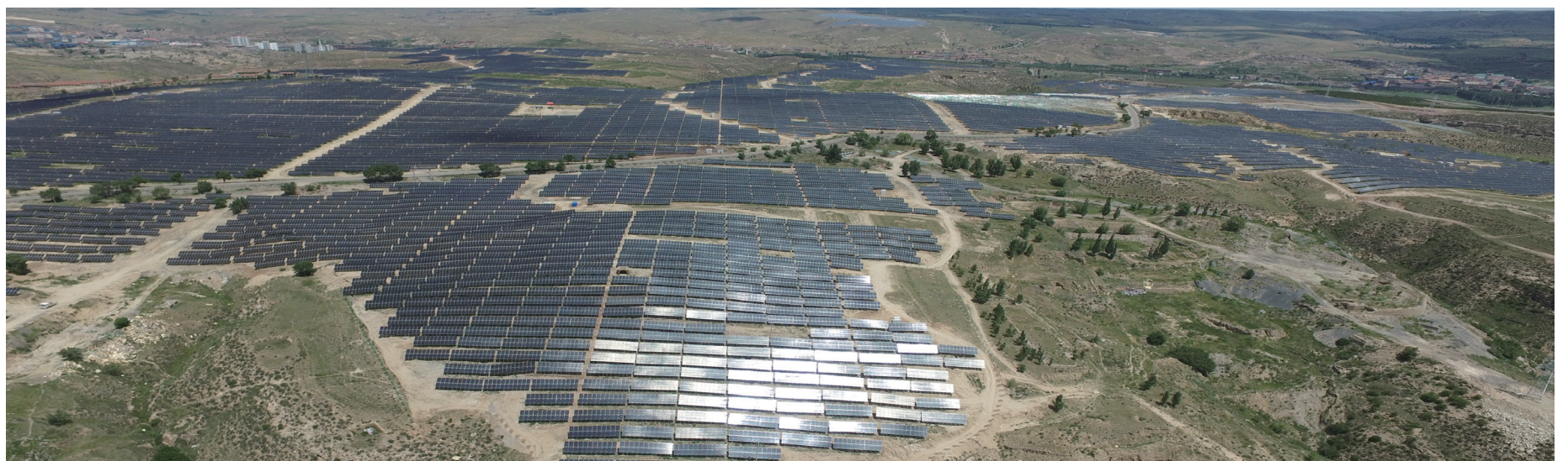
中国山西省大同采煤沉陷区“国家先进技术光伏示范基地”50兆瓦N型双面光伏电站项目
